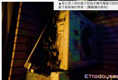
▲ 淡水早日連2起冷氣室外機起火，幸好及時撲滅。(圖/記者陳以昇翻攝，下同)
