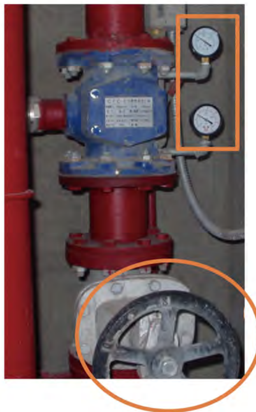
自動撒水設備
