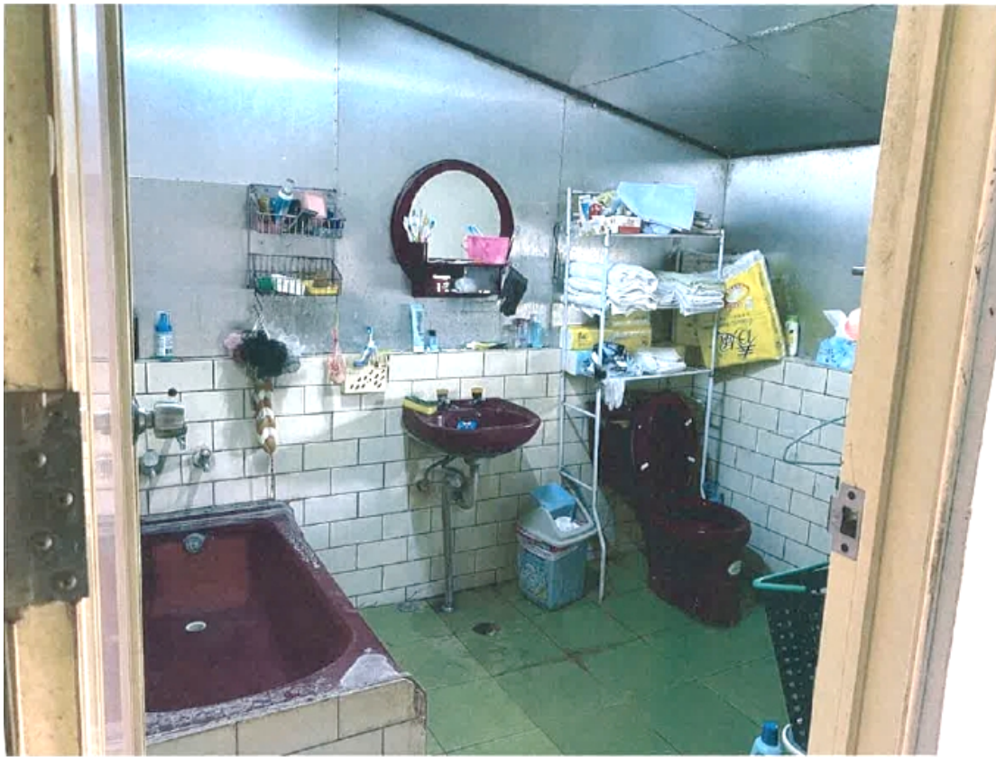
▲ 衛浴設施設備改善 (修繕前)
