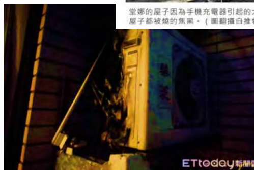
▲ 淡水早日樓2起冷氣室外機起火，幸好及時撲滅。(圖/記者陳以昇翻攝，下同)
