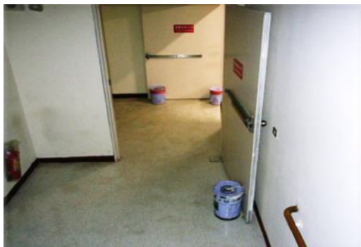
常閉式防火門
