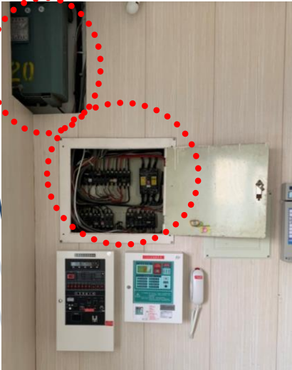
通報裝置不宜靠近電力線或配電盤面
