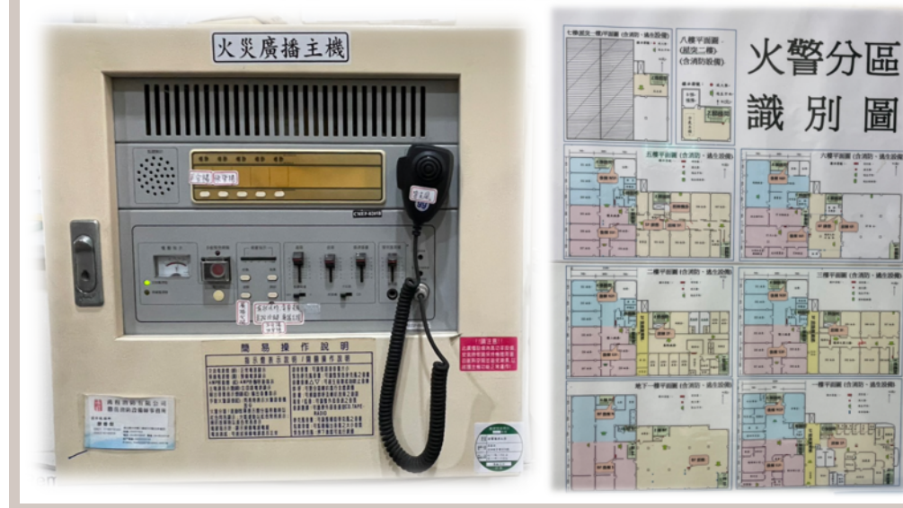
P型火警自動警報設備
